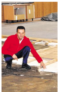
Gerhard Arbes hat den Wasserschaden in der Halle entdeckt. BILD: WEINBACH
